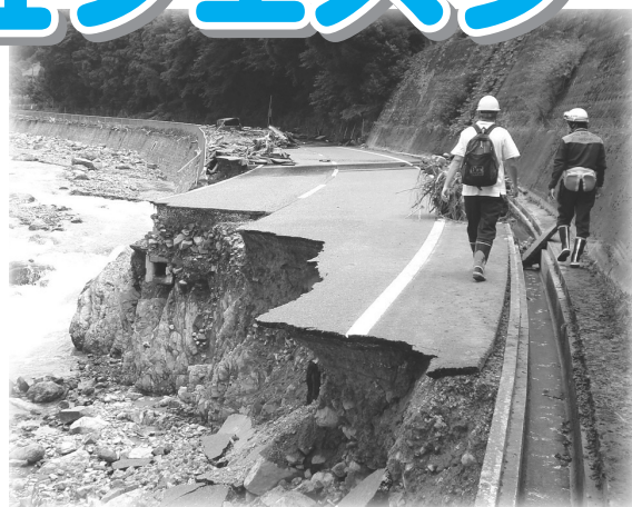
福知川の氾濫で生活道路が崩落
